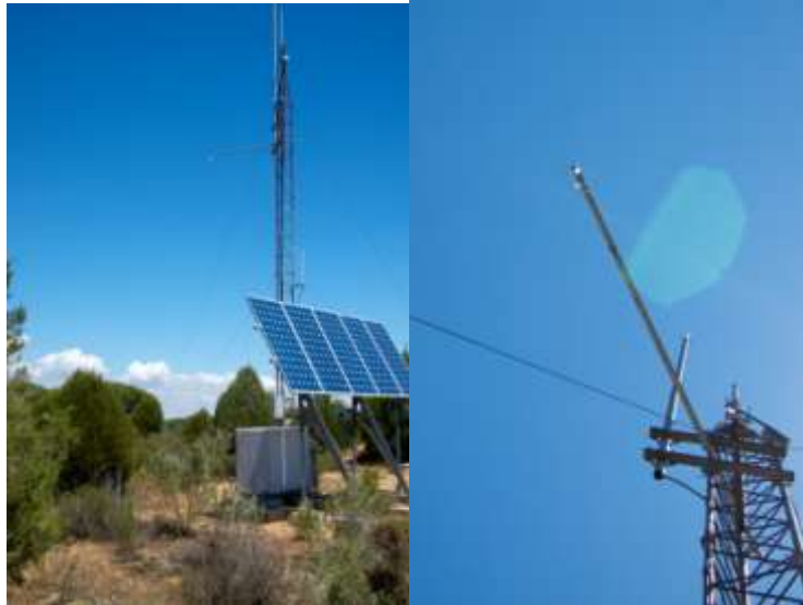
Figura 9. Torre “El Ojillo” con el radiómetro instalado.
